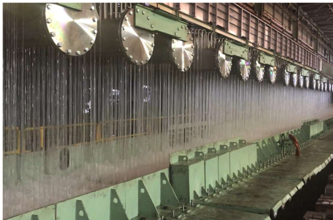
Linha de resfriamento laminar no laminador de tiras a quente da voestalpine Stahl GmbH.
