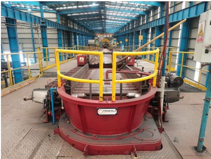
Coletor de bobinas recentemente instalado na laminação de fio-máquina da Celsa France
