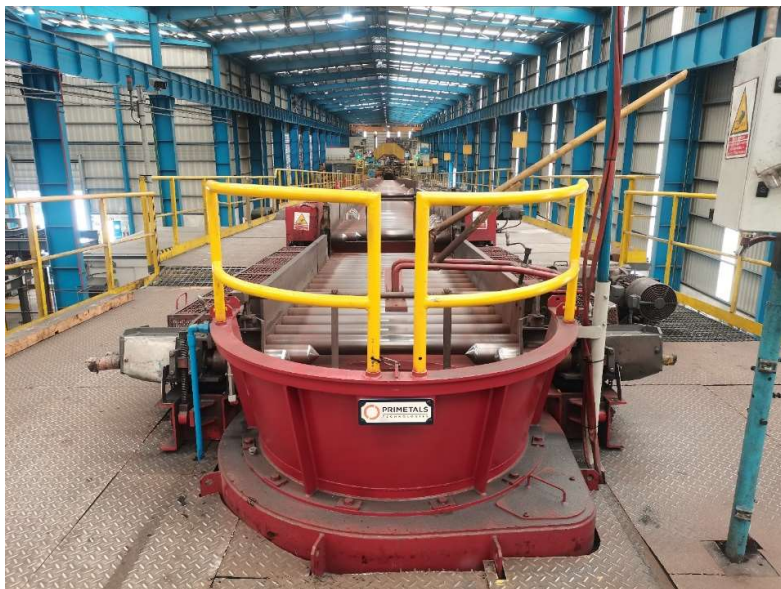
Neu installierter Wickeltrichter im Walzdrahtwerk von Celsa France
