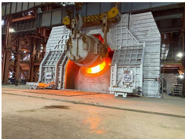
Первая заливка в конвертер «Н» компании JVML; оборудование поставлено фирмой Primetals Technologies.
